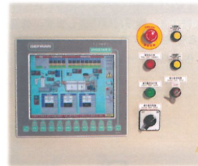
GEPFRAN computer system/ 電腦控制系統
